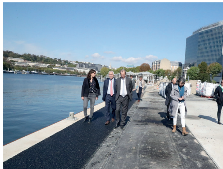
■ Le maire et Georges Siffredi, président du conseil départemental, sur le port Legrand actuellement en réhabilitation dans le cadre du projet de reconquête du fleuve et de ses berges.
