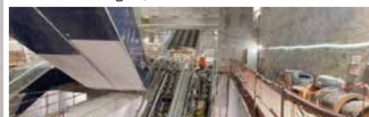
■ De nombreux escaliers mécaniques ont été installés, permettant de rejoindre les quais situés à 23 mètres de profondeur.
